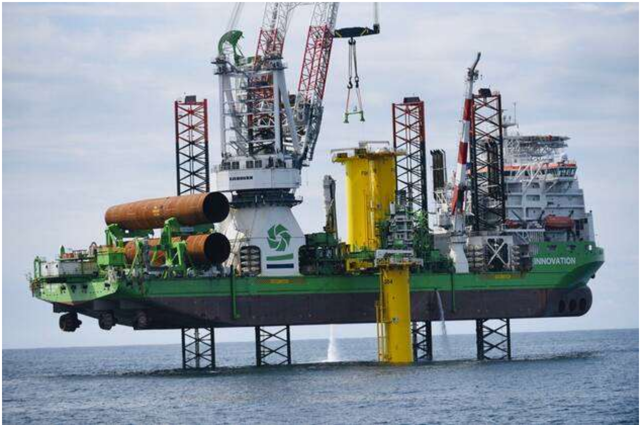
Le navire Innovation opéré par Deme est en charge de l'installation des 80 fondations d'éoliennes. | PHOTO PRODUCTION CAPA CORPORATE
